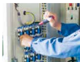
制御盤の設計から、製作、検査、据付、試運転、メンテナンスまで一貫サービス
